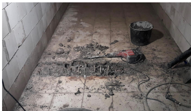
Zdjęcie ukazujące szerszą perspektywę. Widać pomieszczenie i umiejscowienie uszkodzenia względem ścian.
