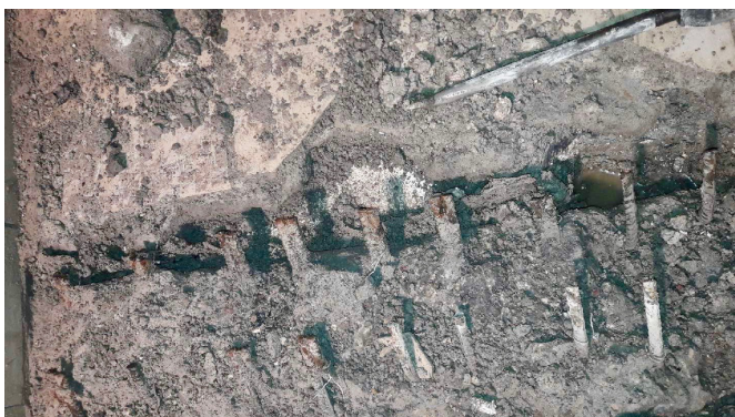
Zdjęcie zrobione ze zbyt małej odległości. Brak możliwości podjęcia decyzji przez osoby spoza budowy. Konieczne zdjęcia dodatkowe.
